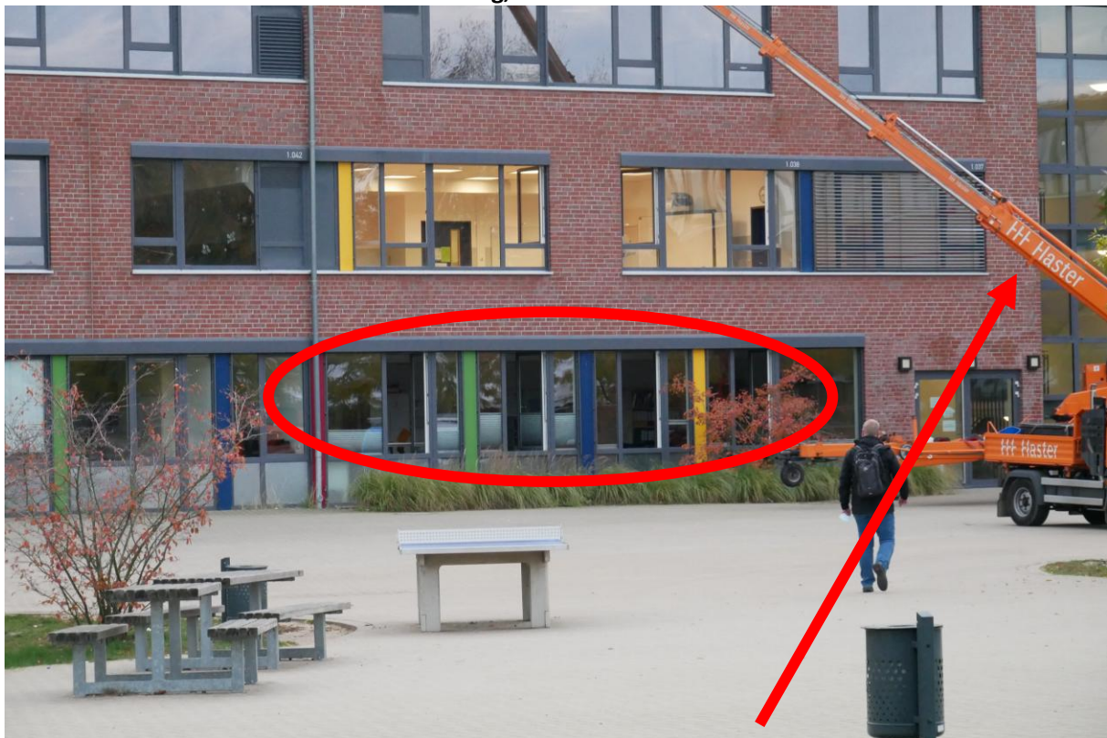
Arbeitsbühne der Firma Haster zur Außenreinigung der Fenster
